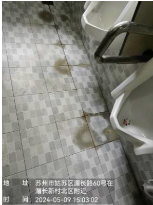
地砖破损且陈旧
