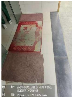
防滑垫破损且有污迹
