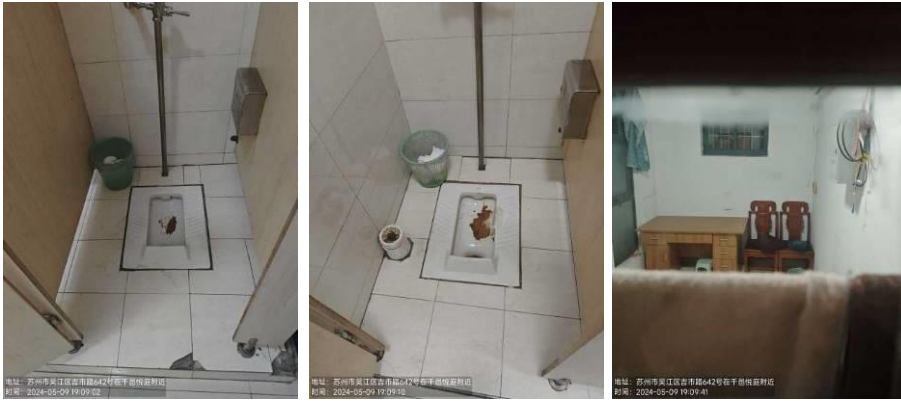
蹲位未冲洗、无保洁员
